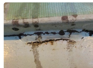
隅肉溶接部の亀裂
